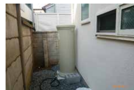
非常用の雨水タンク(トイレ用水など)
